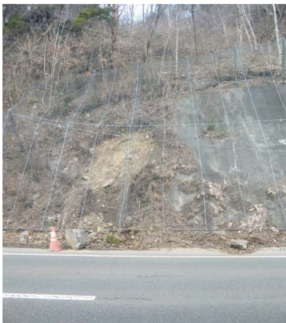
落石発生箇所(正面より撮影)
