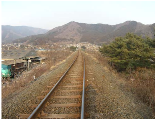
大船渡市中道下地区 被災状況 (3/3)
