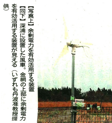
【写真上】余剰電力を有効活用する装置 【同下】深浦に設置した風車。金網の上部に余剰電力を有効活用する装置が見える(いずれも丹波准教授提供)
