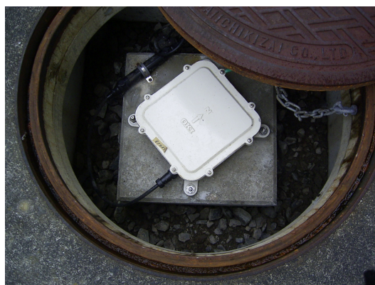
写真-4 震度計センサーの設置状況(2008年9月25日撮影)
