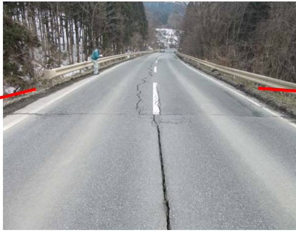
路面状況 道路CLに亀裂発生
