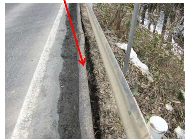
法肩変状状況
