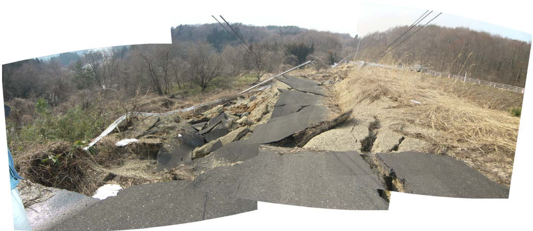
地すべりブロック中間部(旧国道)の状況
