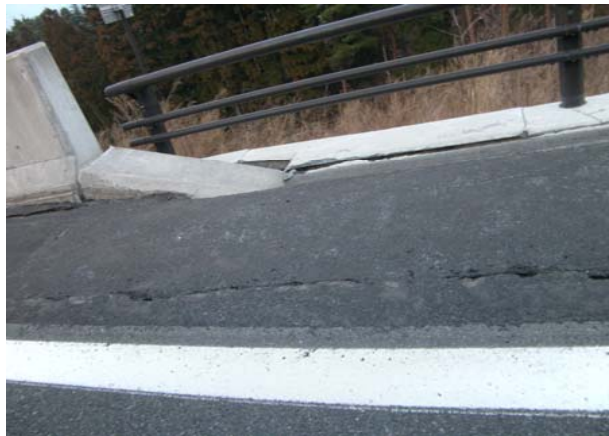
段差・亀裂発生状況(①箇所)
